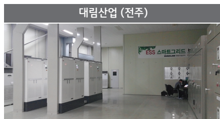
PCS : 1MW / 배터리 : 2MWh 부하 이동용
