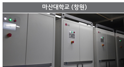
PCS : 1MW / 배터리 : 2MWh 부하 이동용
