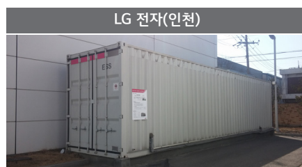
PCS : 4MW / 배터리 : 1MWh 주파수 조정용
