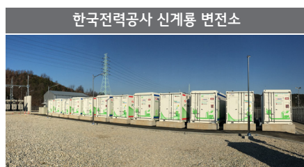
PCS : 24MW / 배터리 : 6MWh 주파수 조정용
